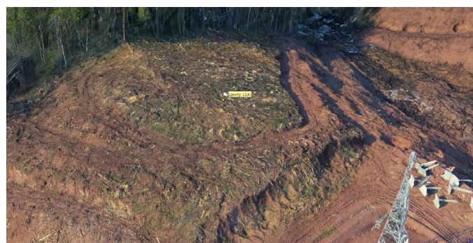
Рис. 1. Место под пикет строящейся ВЛЭП
